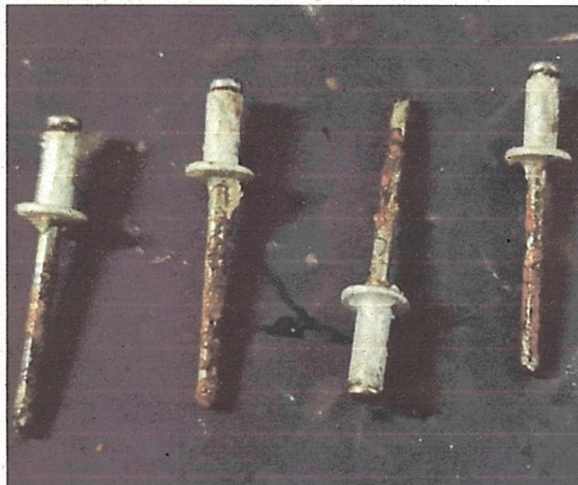
Foto nº. 03 Corrosão dos rebites.
